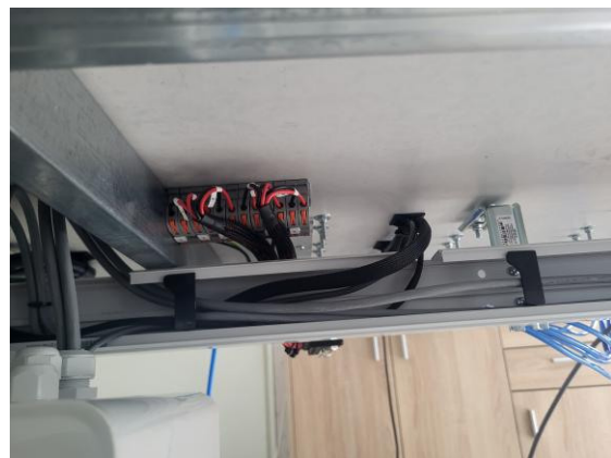
Abbildung 137: Verkabelung von vorne
